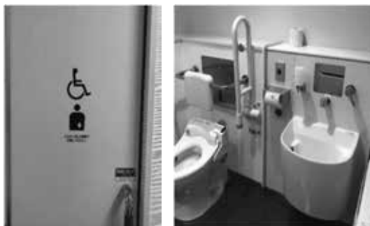
写真1 本学のオストメイト対応トイレ
